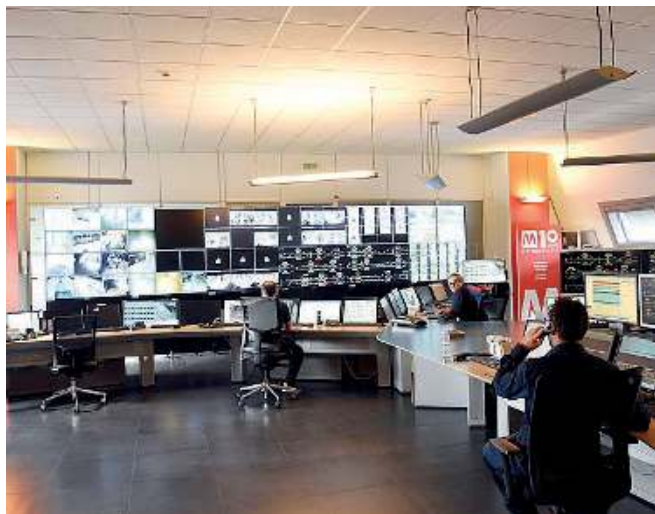
La nuova centrale. Gli schermi nella sala al deposito di Sant'Eufemia
